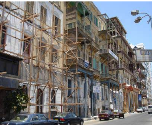
شكل (٣- ٢٦) المباني المطلة على قناة السويس عام ١٩١٠م وعام ٢٠٠٩م ويظهر بهما استخدام الحجارة كأساس للإنشاء والأخشاب للتراسات الخارجية.
