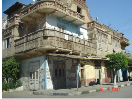
شكل (٥- ٢٦) أحد المباني السكنية القديمة ويوضح تهاكها المصدر: الباحث
